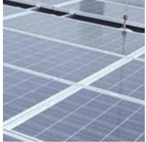
Hệ thống Pin mặt trời của tòa nhà
