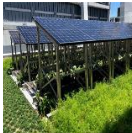
Các tấm pin mặt trời trên mái tòa nhà
