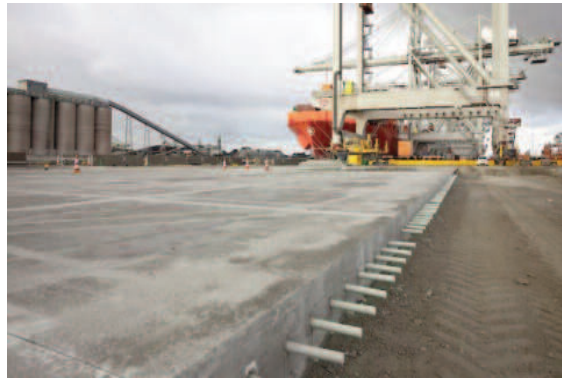
184.000 miếng chốt GFRP Mateen Pultron 38 mm đã được sử dụng trong dự án nâng cấp xây dựng Cảng container Rotterdam, Hà Lan (2019).
