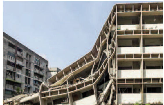
Hình minh họa 1 công trình bị sụp đổ do vấn đề ăn mòn bê tông.
