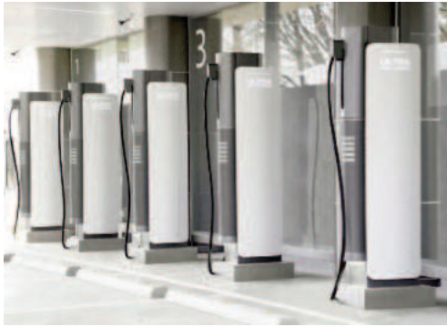
Hệ thống trạm sạc xe điện.
