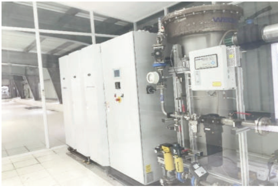
Module ozon hóa tại Nhà máy nước Tân Hiệp 2, Tp. Hồ Chí Minh
