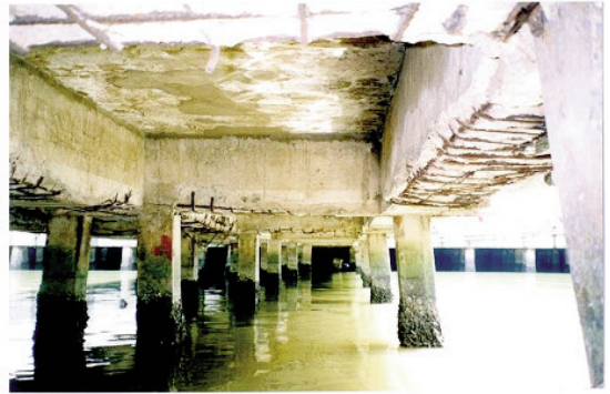
Nứt do ăn mòn cốt thép trong bê tông.
