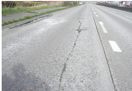
Chênh lệch nhiệt độ ảnh hưởng đến độ nứt trong kết cấu bê tông cốt thép.
